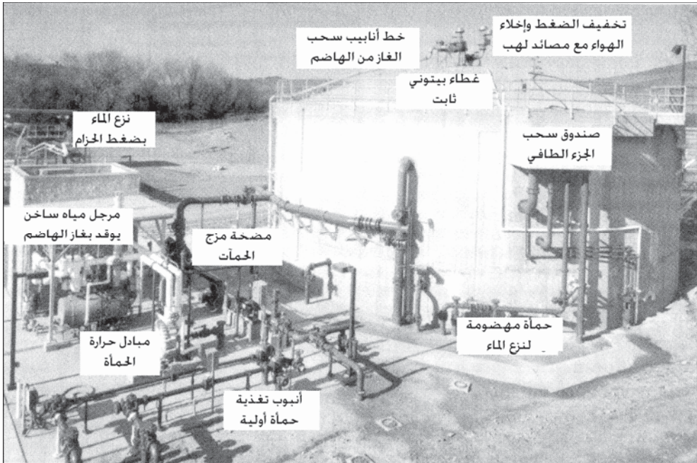
شكل 11-57 : صورة لهاضم لاهوائي بمرحلة وحيدة ذي غطاء ثابت. تتضمن معدات الدعم نظام التسخين (مرجل مياه ساخن، ومبادل لحرارة الحمأة). شبكة أنابيب لسحب لغاز، تغذية بالحمأة، وشبكة أنابيب للسحب (EI)
